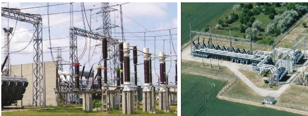
Martonvásár 400 / 220 kV-os Alállomás
