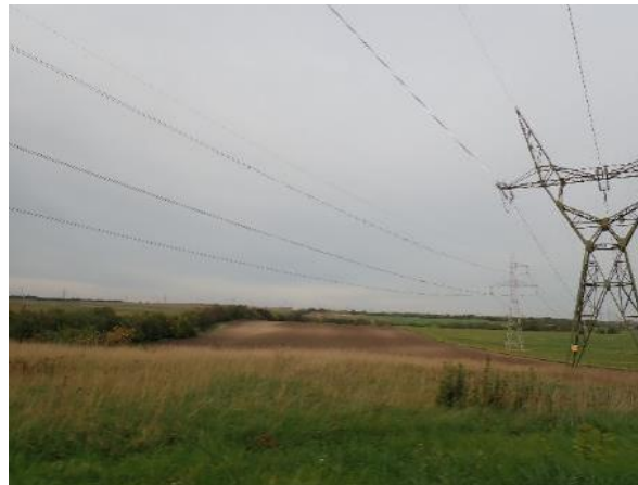
Villanyvezeték (forrás: saját fotó)
